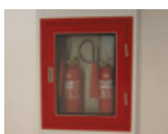
Caixa de hidrantes e extintores
